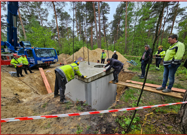
Frühjahr 2024: Der tonnenschwere Betondeckel wird mithilfe eines Krans auf den neuen Brunnenschacht gesetzt.
